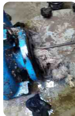
Dégâts sur le clapet anti-retour
